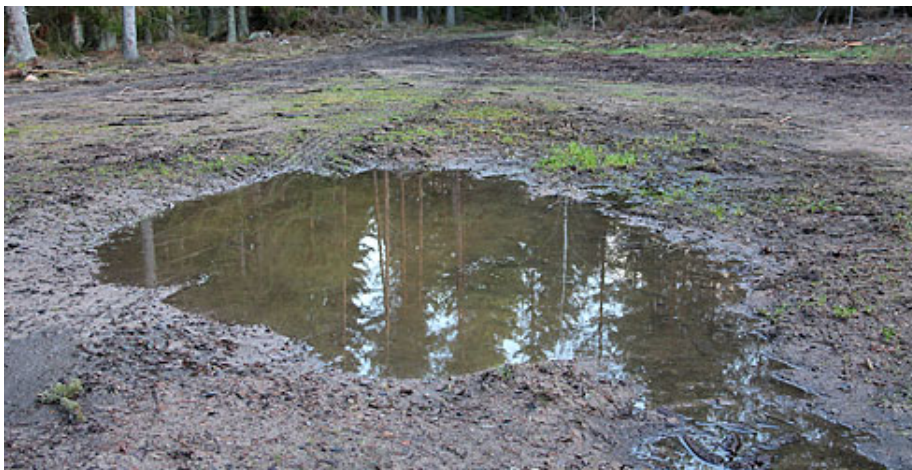
Stående vatten är vatten som blir kvar på vägbanan efter nederbörd. Foto Mats Hannerz.
