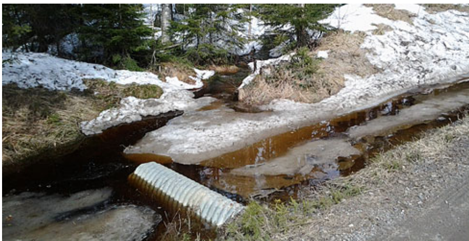
Vägtrummorna får lätt stopp under vintern. Foto Per Hallgren.
