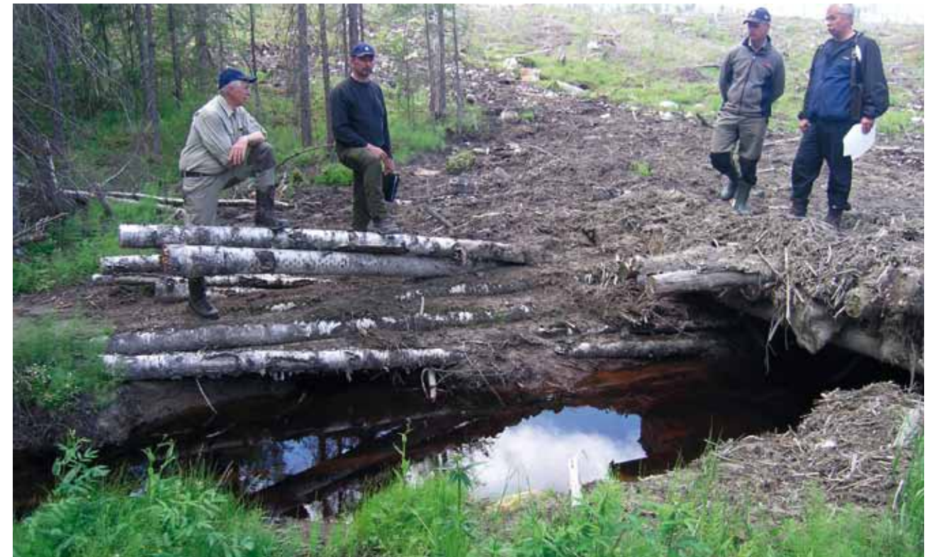
Trots att man byggt en bra bro har körskadorna medfört att slam transporterats ut i bäcken via körspåren. Det är viktigt att på- och avfarten till bron görs så att detta inte kan ske, till exempel genom risning eller kavling.
